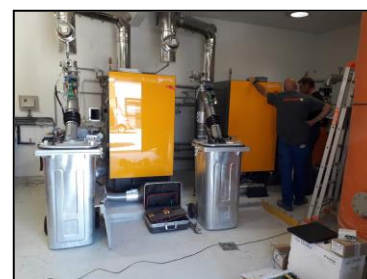
Chaudière Bois Azé La Varenne
